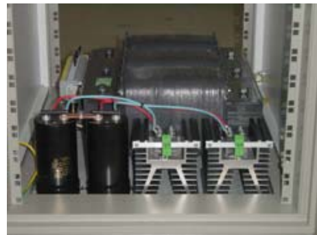
Hochstrom DC-Versorgung im Schrankgehäuse
